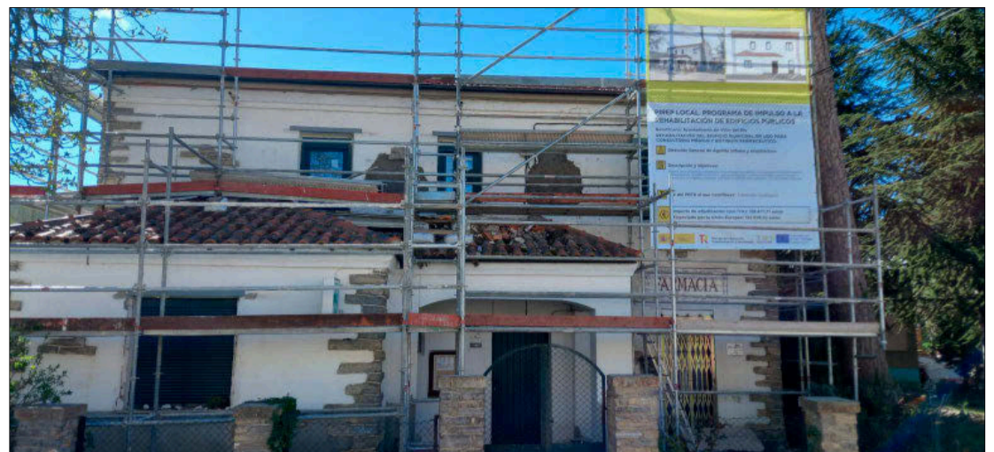
El edificio del consultorio médico y farmacia de Villar del Río ya está en obras. HDS
